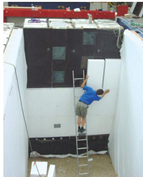
Bild 7. Meßinstrumente in der Widerlagerwand, Einbau der Polystyrolplatten
